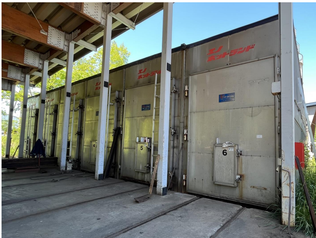
写真 2.1-1 蒸気式乾燥機
