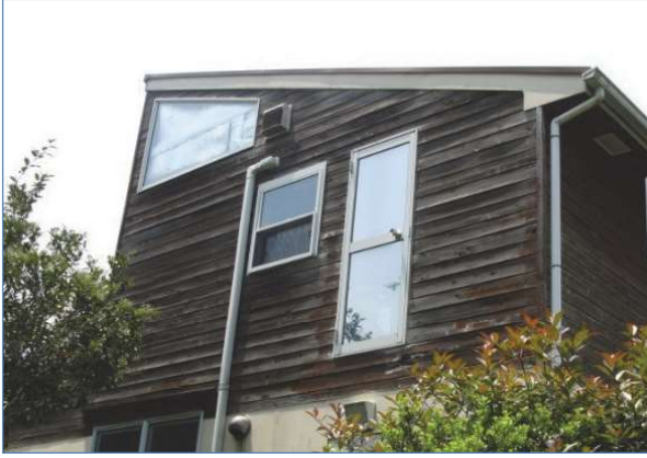
写真 1.5 下見板の幅反り及び縦反り
