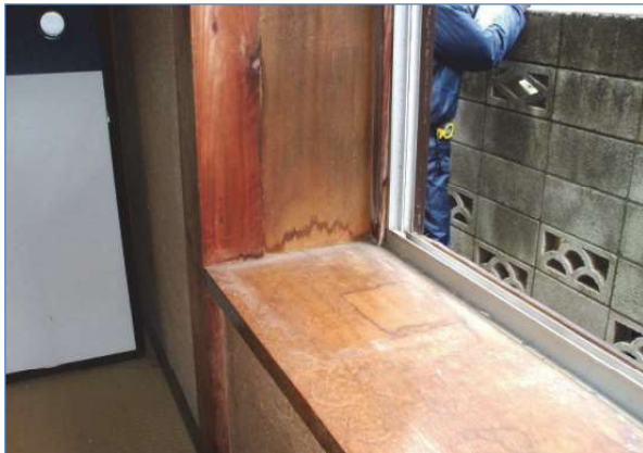
写真 1.14 窓枠に発生した雨染み（室内側）
