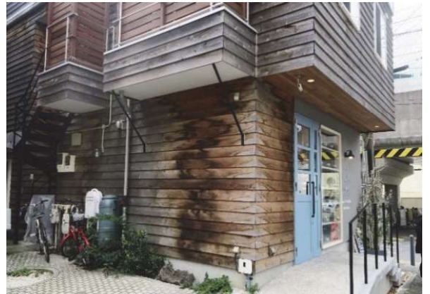
写真 1.15 南京下見板（ベイスギ無塗装）の雨染み
