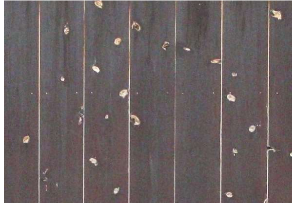
写真 1.11 造膜形塗装における節部の塗膜脱落
