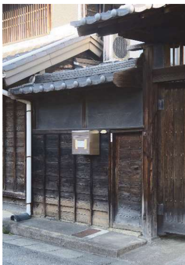
写真 1.17 外壁地際部の変色
