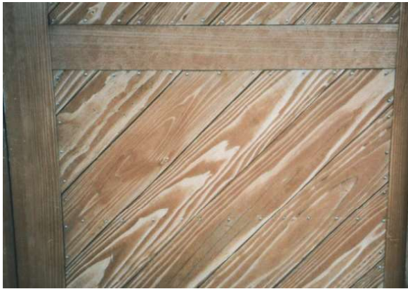
写真 1.12 含浸形塗装の色抜け
