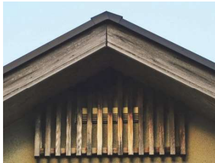
破風の栞に発生した隙間（対策しない場合）
