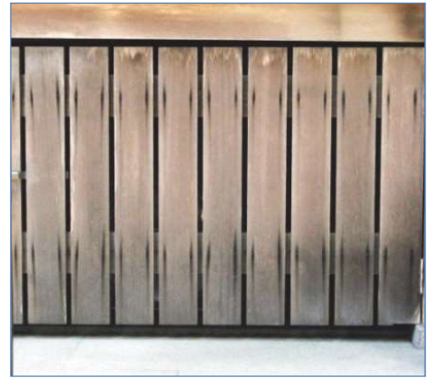
写真 1.13 板塀固定金具による鉄汚染
