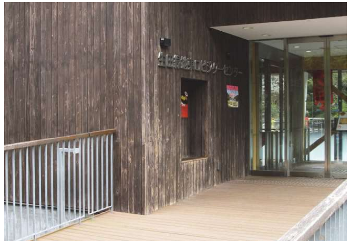
写真 1.23 歩行者の通行による塗装壁面の摩耗
