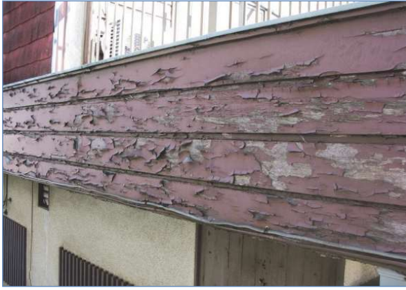
写真 1.10 造膜形塗装の塗膜剥離
