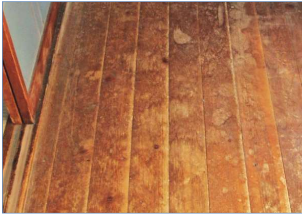
写真 1.21 縁甲板の生活汚染 (25年経過)
