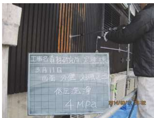
写真 3.8 高圧水洗浄法による既存塗膜の剥離工程 （この例では材面保護のため比較的低压に設定）
